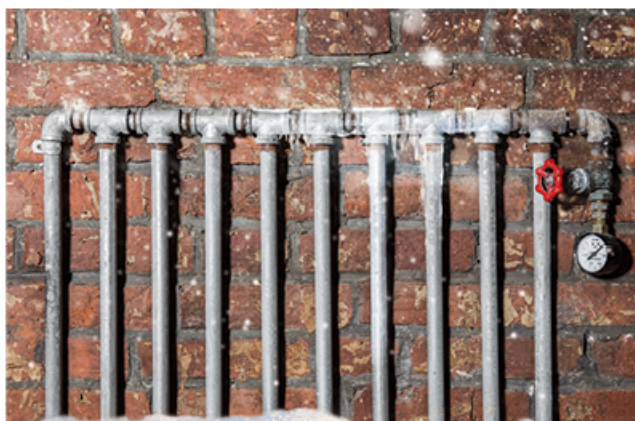
Các hệ thống ống nổi
