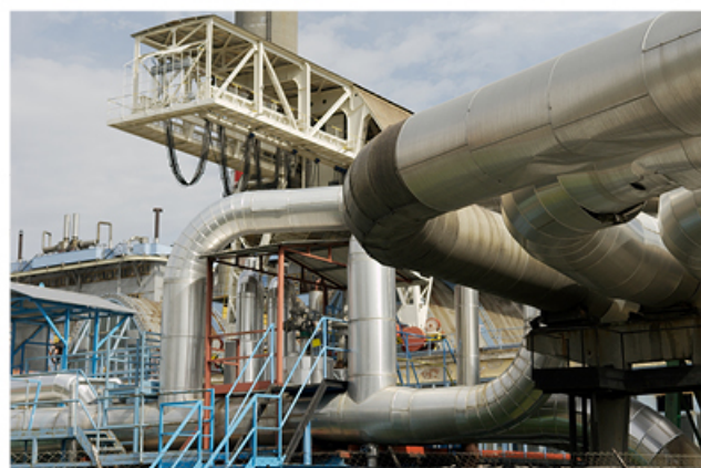
様々なタンクのヒーティング設備
