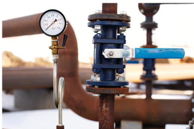
パイプ、水道メーター
